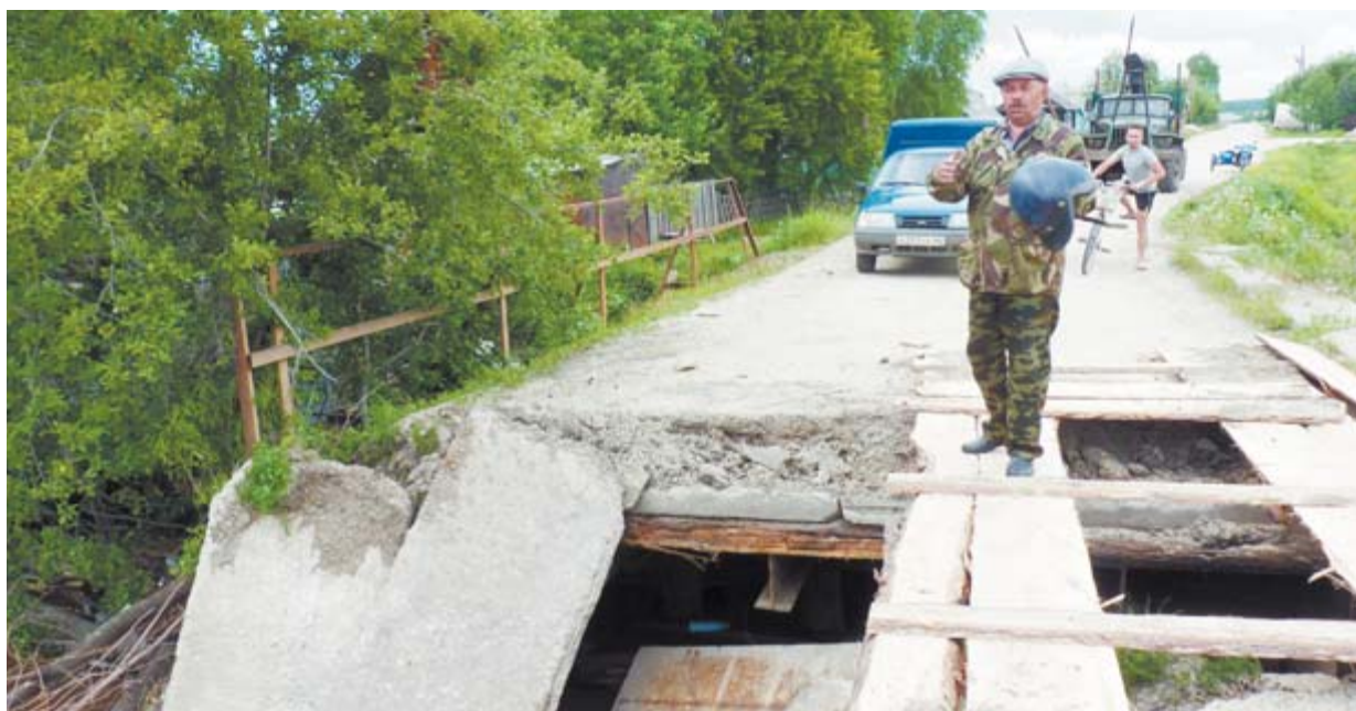
Через провал по ул. Октябрьской сделан временный мост
