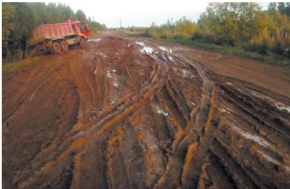
По дороге в Болотовское постоянно застревают автомобили
