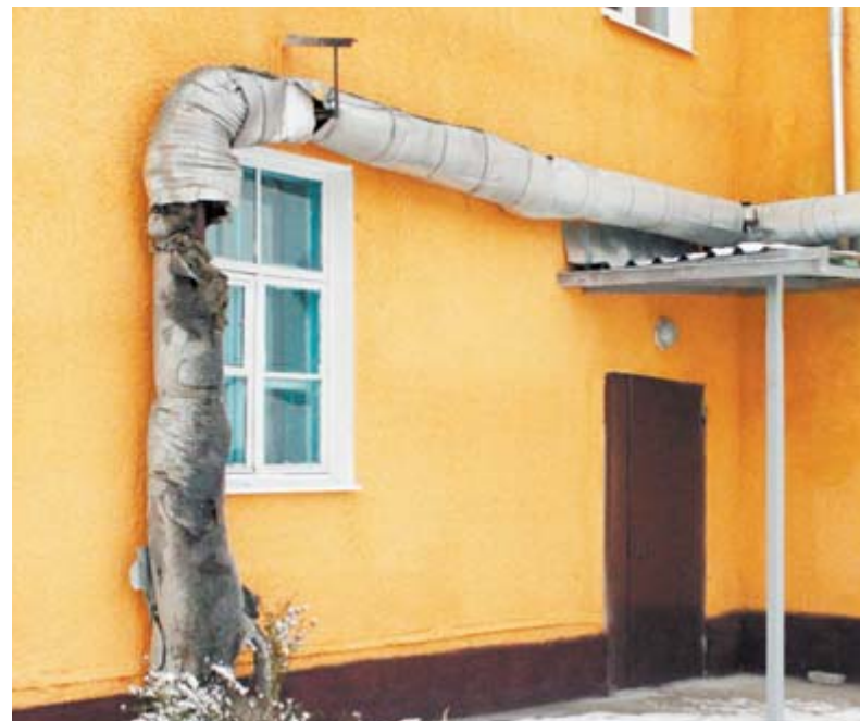
Внешний вид дома портит труба теплотрассы с оборванной теплоизоляцией. Кто должен привести в порядок трубу: ресурсоснабжающая или управляющая компания, пока остаётся под вопросом
