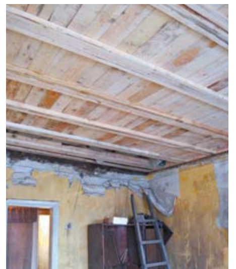
Работники активно меняют чердачное перекрытие над квартирой № 4, и отмечают, что брусья и доски - все прогнили
