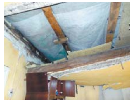
Если бы не шкаф, потолочная балка могла проломить пол
