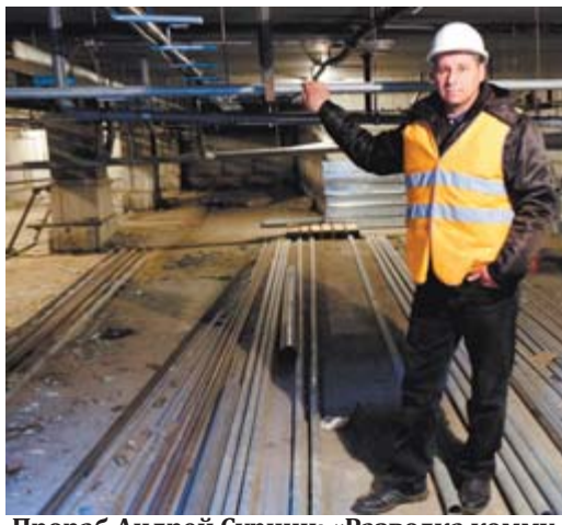
Прораб Андрей Сурнин: «Разводка коммуникаций, находящихся в школе, и приборы учёта отопления и водоснабжения будут находиться в подвале пристроя, так как в основном здании, построенном в 1936 году, подвала нет»
