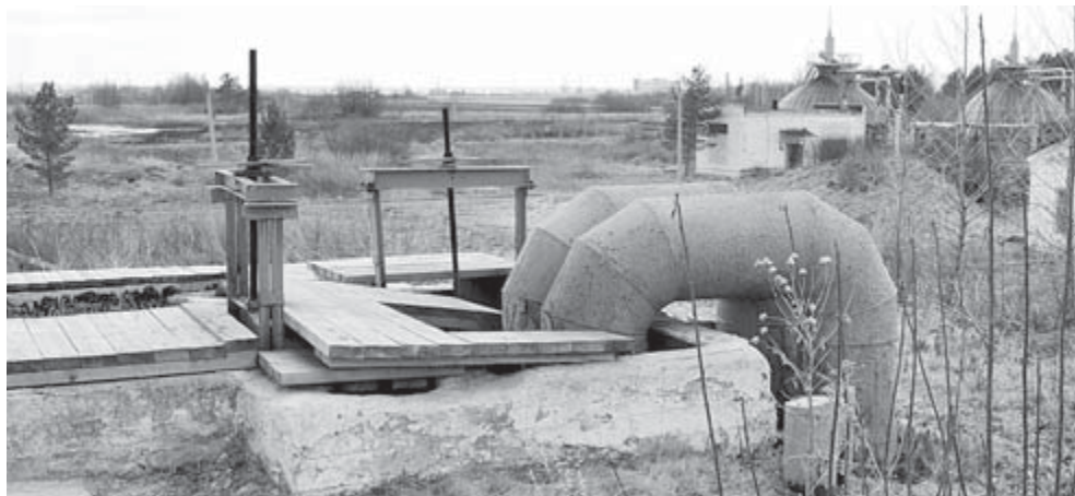
По этим трубам стоки со всего города поступают на очистные сооружения
