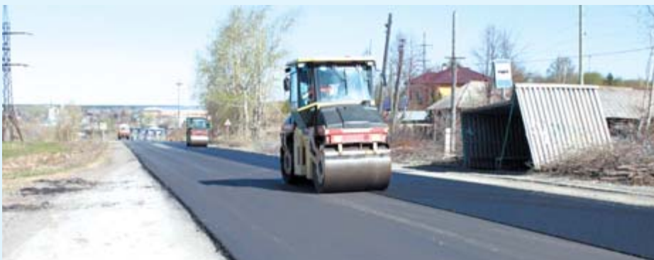
На улице Ялунинской укладывают первый слой асфальтового полотна и бордюрный камень. Тротуар по-прежнему будет только с одной стороны.
