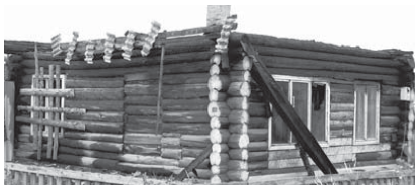
Последствия пожара на ул. Коростелёва
