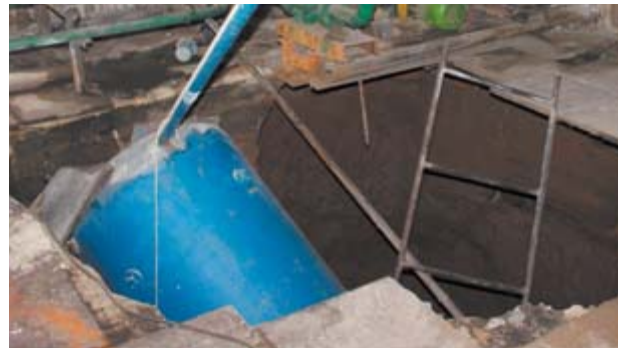
Авария на котельной по ул. Горняков, 6
