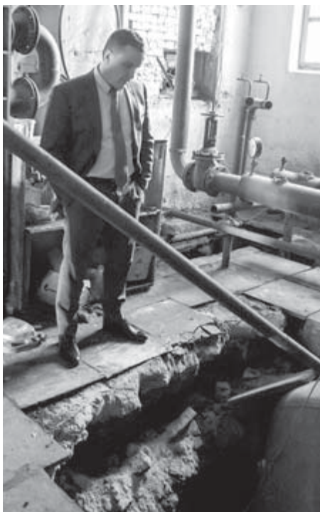
В аварийной котельной по ул. Горняков
