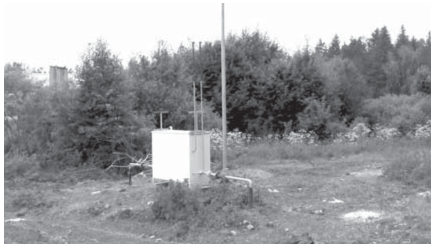
Газораспределительный шкаф в районе для СПК «Сибиряк»
