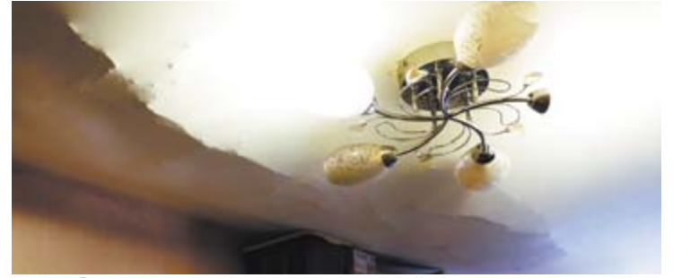
В результате пожара повреждён потолок в квартире
