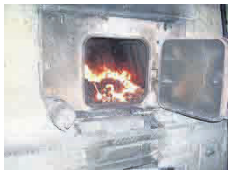
Часть котельных в Арамили модернизируют. Одна из них готовится к полной реконструкции
