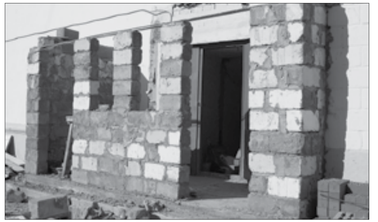
По предписаниям пожарных в школе № 14 строится новый запасной выход, соответствующий необходимым требованиям
