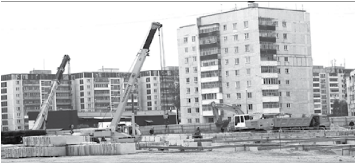
Строительство детского сада в микрорайоне Зелёный Бор-2. В настоящее время на объекте закончены работы нулевого цикла, ведётся кладка стен первого этажа
