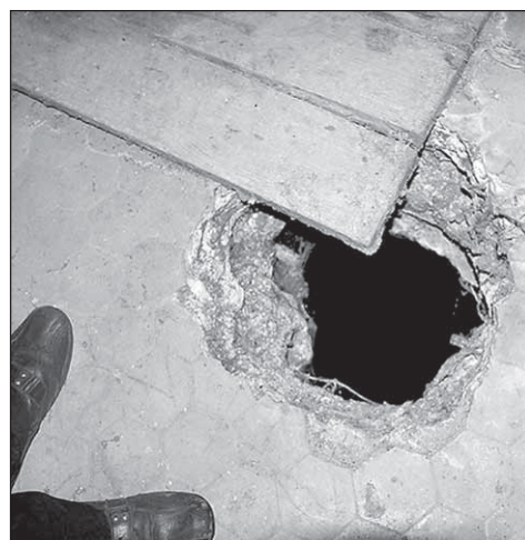
Состояние помещений в местах общего пользования – аховое. Сторожилы утверждают, что ремонта там не видели
