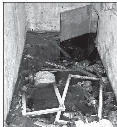
В подвал невозможно зайти даже в болотных сапогах. Помимо воды, он также заполнен мусором
