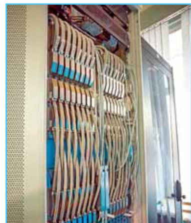
Новое оборудование станции автоматически обслуживает звонки жителей со всего Урала
