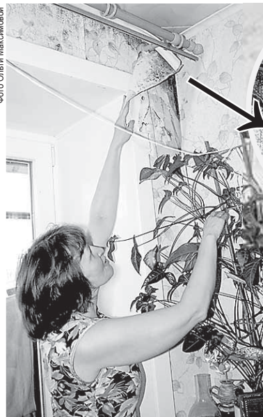
Ремонт придётся делать заново: на потолке над окнами выросла чёрная плесень, от влаги обои отходят от стен
