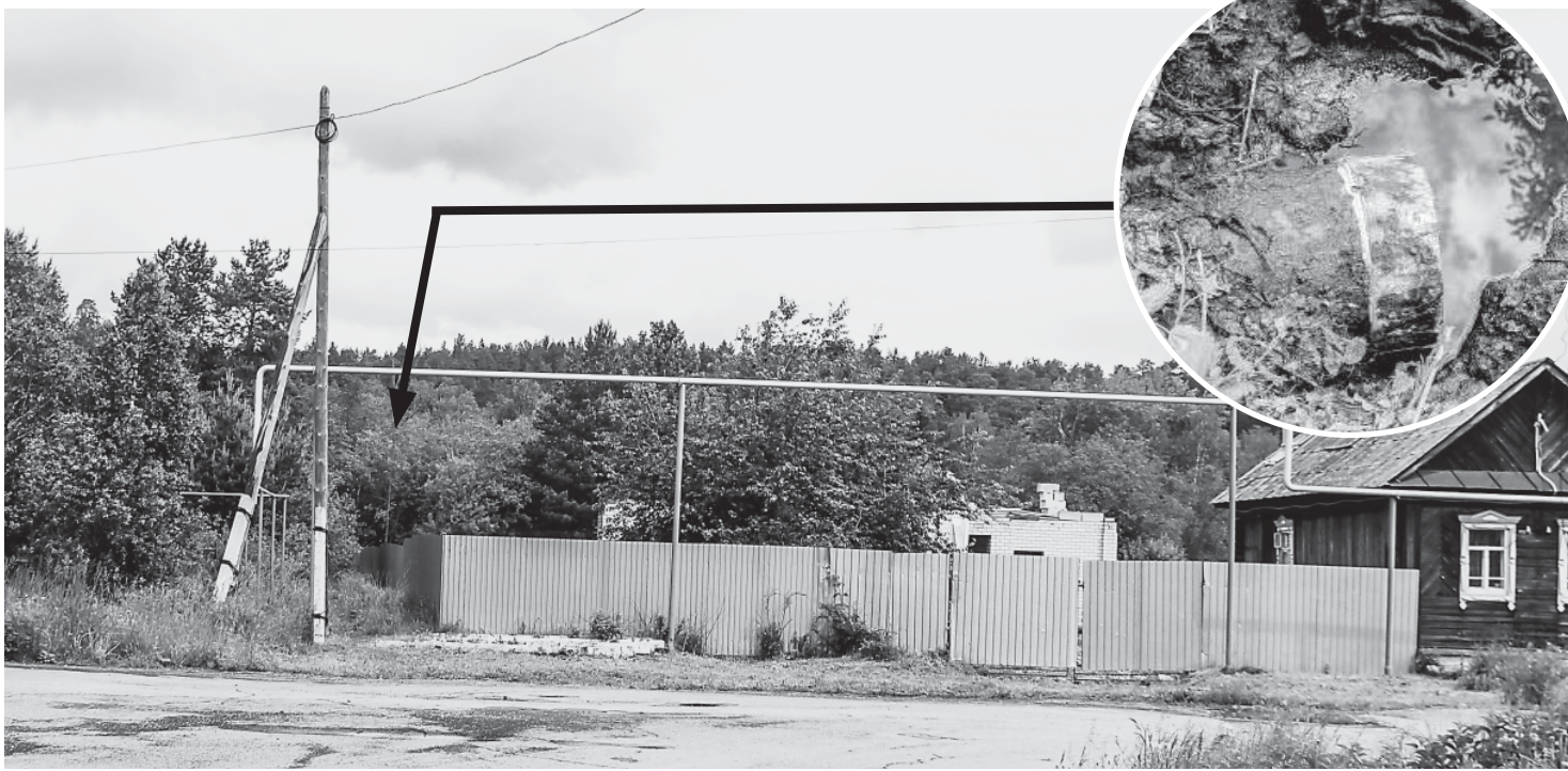
Дренажная труба, из которой вытекает вода с неприятным запахом, проложена в проулке на улице Ленина, между домами №88 и 88А. Неделю назад в неё забili деревянную заглушку
