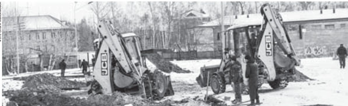
Во дворе школы началось строительство нового стадиона – с беговыми дорожками, прыжковым сектором, игровыми площадками
