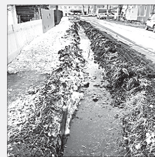
При засорении ливнёвки вода поступает под фундамент
