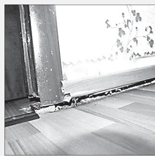
Дом «водит», пол отошёл от стен
