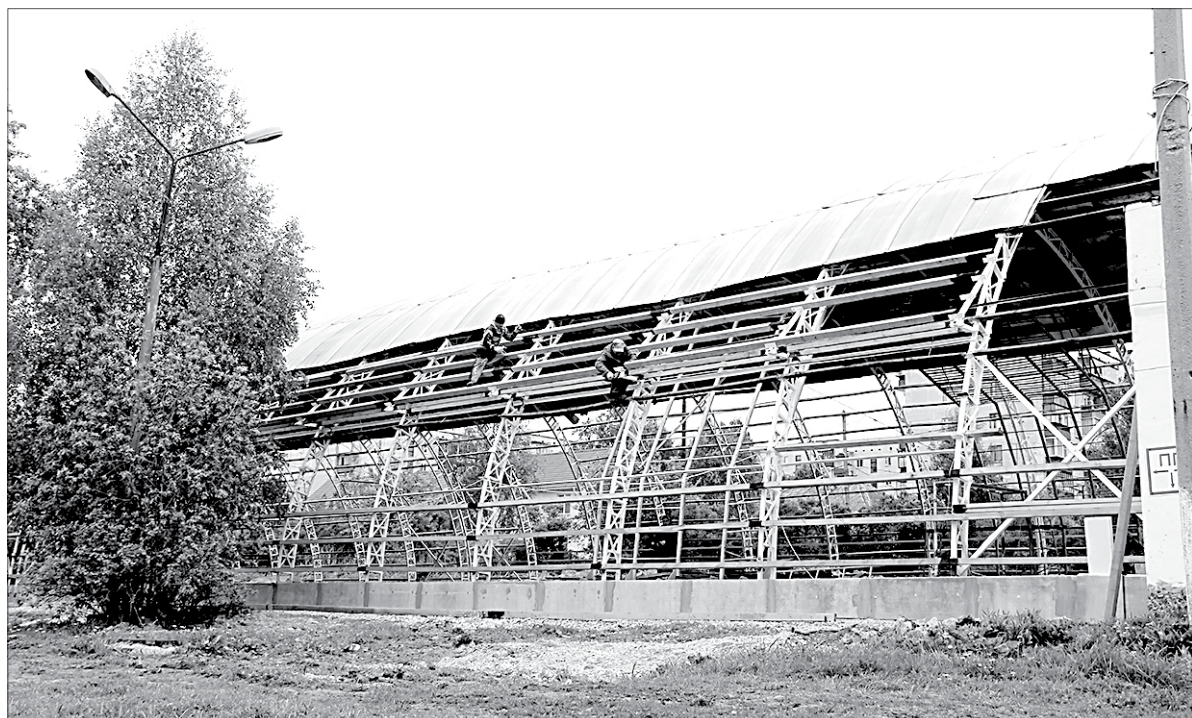
Капитальный ремонт спортивного манежа включает в себя обновление от пола до крыши. Старым остаётся только остов сооружения. Основную часть строительных работ планируется закончить к юбилею города
