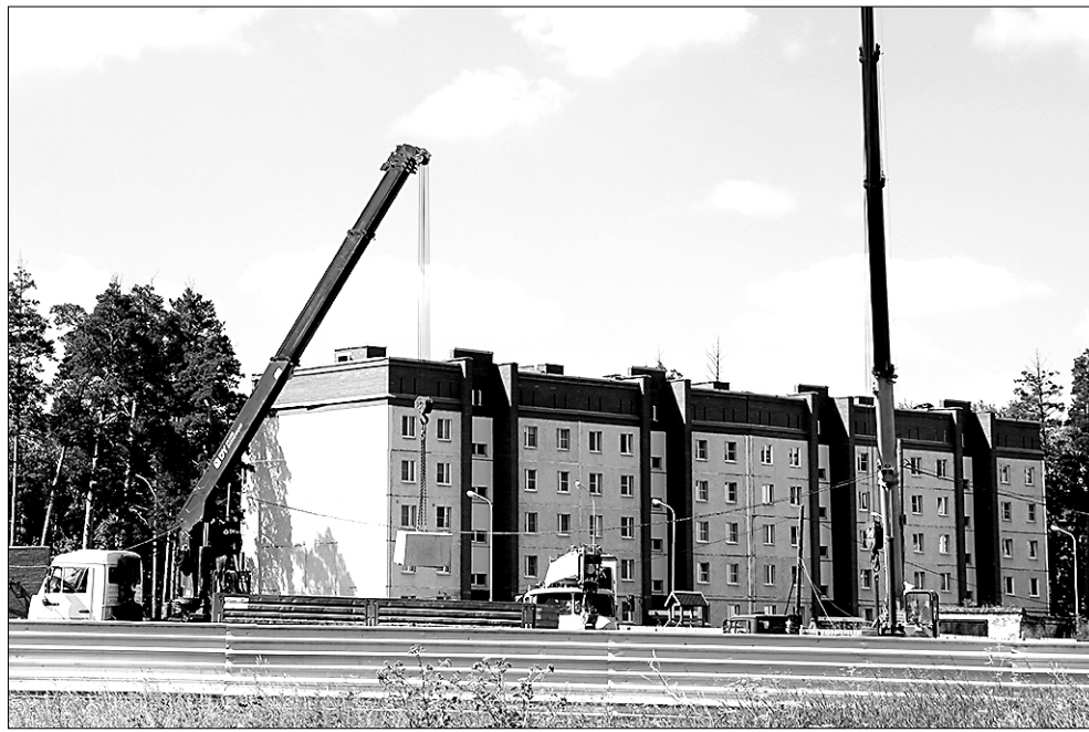
Пятиэтажный дом на 36 квартир строят на улице Розы Люксембург в районе дома № 112. Сегодня закладывают фундамент
