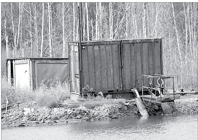
Узел нейтрализации, который построили в 2014 году, нейтрализует самоизливающиеся воды из южного провала шахты Гумешевского рудника
