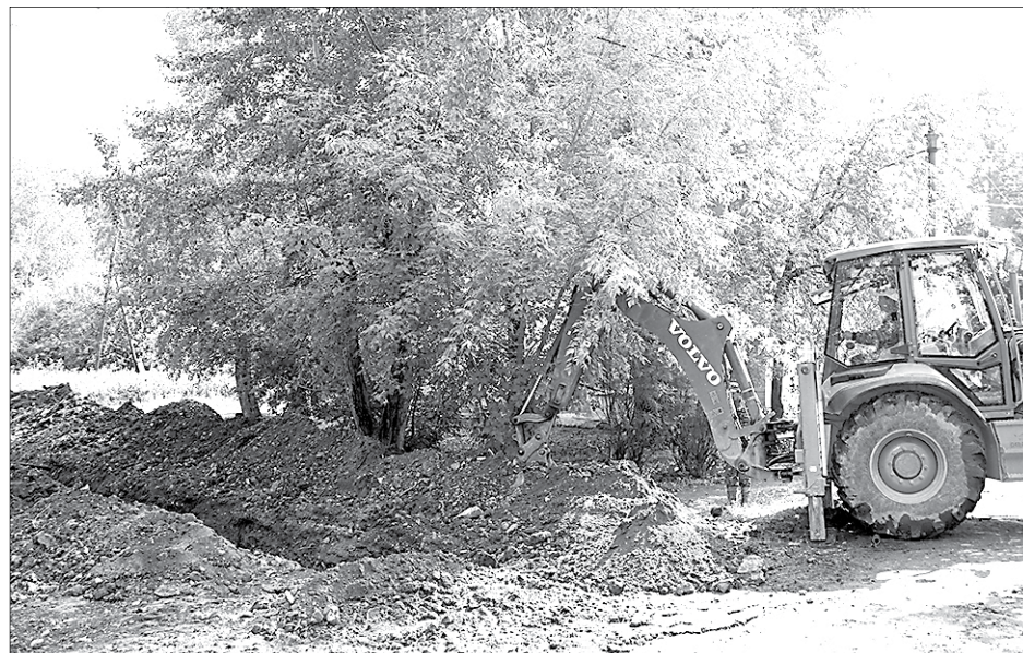
Капитальный ремонт теплосетей на «юге» даёт надежду, что отопительный сезон пройдёт без крупных аварий
