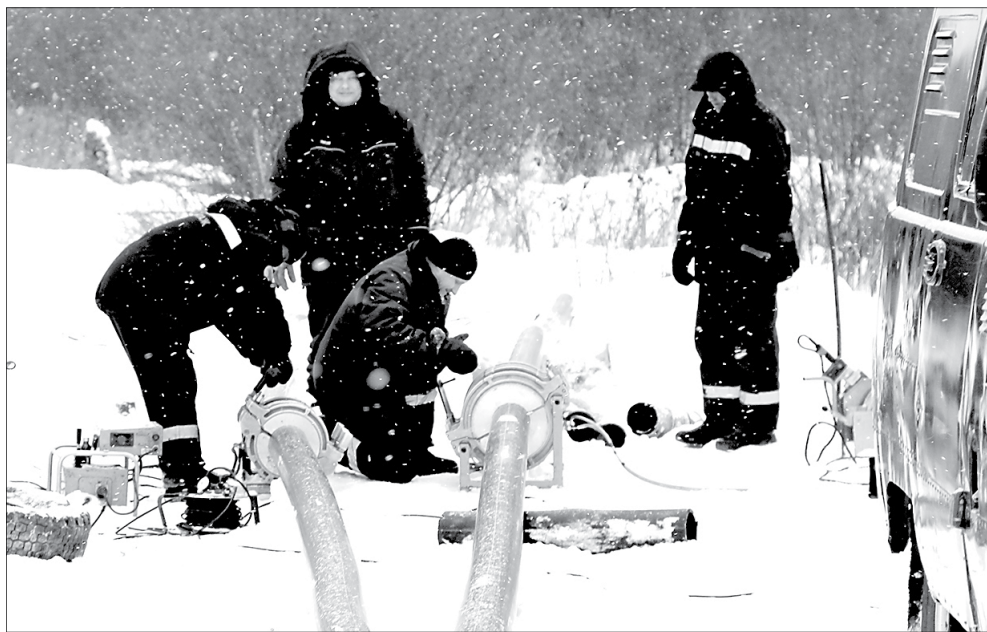
Газопровод высокого давления подвели к Полдневой в 2015 году
