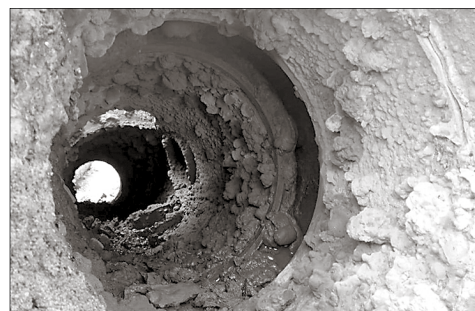
Что называется, судите сами: состояние водопроводных сетей в южной части города
