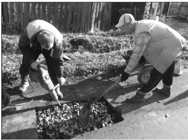
Работники МБУ «Муниципальный заказчик» Денис Андросенко и Максим Жарков производят ямочный ремонт на ул. Лермонтова.
