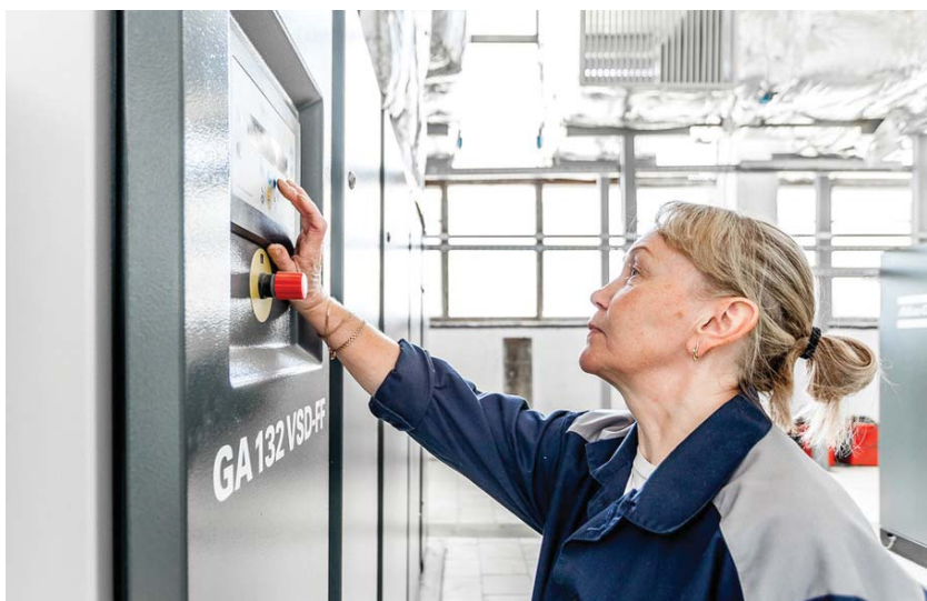
В новой компрессорной КЗФ
