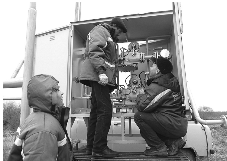
Работники ОАО «Уральские газовые сети» С.А. Турыгин (мастер), А.А. Ильин и И.А. Плешаков (слесари) проверяют запорную арматуру.
