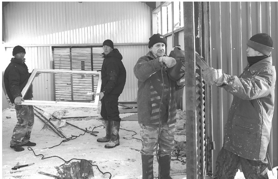
Строительство здания ТЭС завершают работники ООО «Смена» А.А. Зарипов, А.В. Юдин, Ю.И. Семивражнов и Ф.М. Гелимшин.
