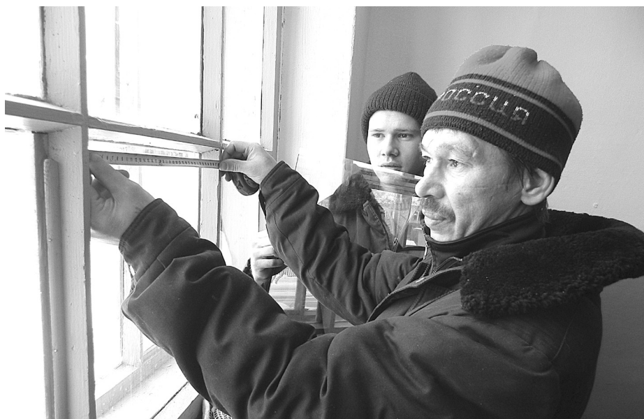
Работники ООО «Жилье» Ю.М. Круглов и И.Г. Демин завершают остекление подъездных рам.
