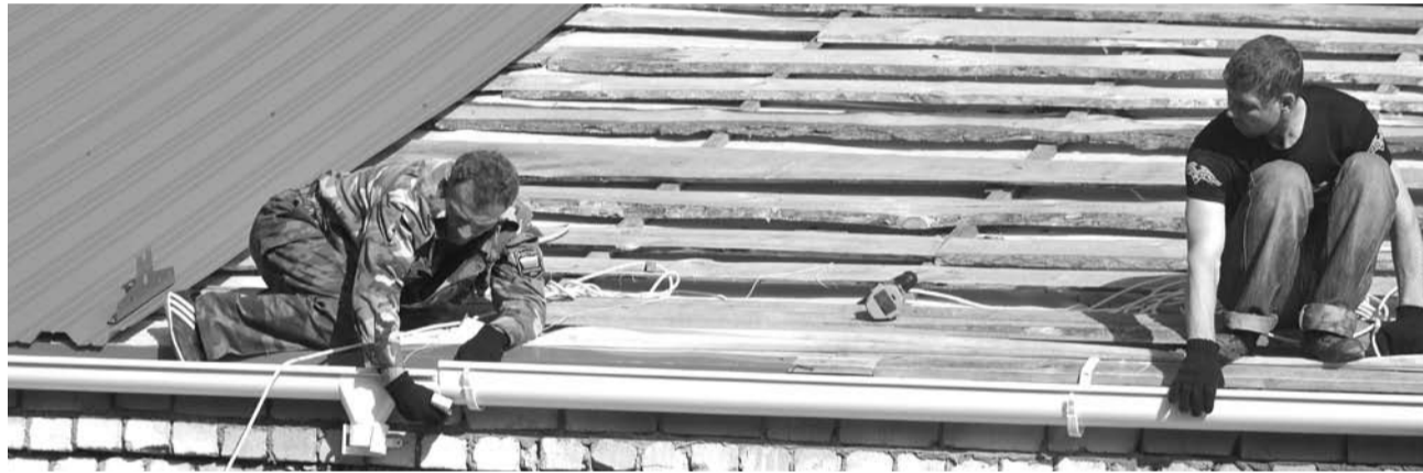
За 45 лет кровля одного из корпусов Троицкого детсада сильно обветшала, поэтому ремонт здания начался с её замены.
