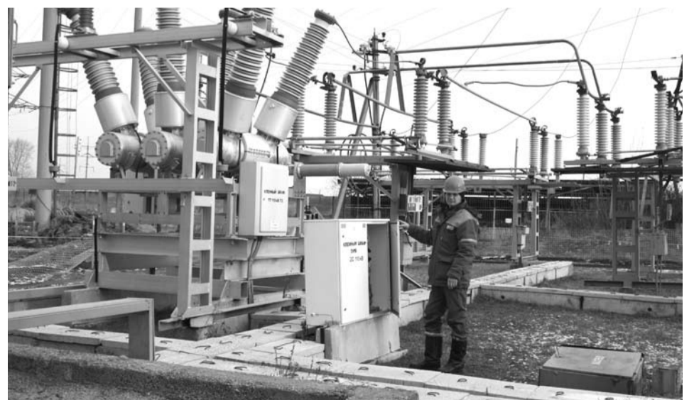
Осмотр оборудования открытого распределительного устройства подстанции «Тыгиш» проводит старший диспетчер Богдановичского РЭС Олег Обоскалов.
