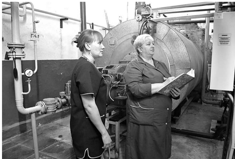
Практически все котельные ГО Богданович эксплуатирует МУП «БТС». Работницы котельной №1 «БТС» Надежда Румянцева и Светлана Белых снимают показания теплового режима котлов.
