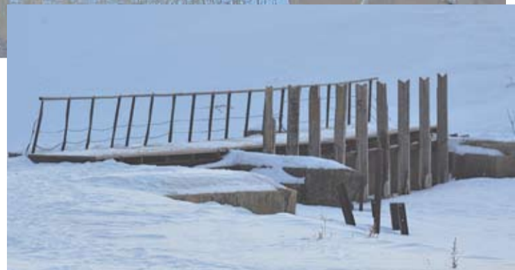
Плотина – сооружение, созданное для защиты от паводков. Пока Глуховская плотина утопает в снегу. Но даже растаявший снег не должен вызвать затопления – наш городской округ считается паводкобезопасным.
