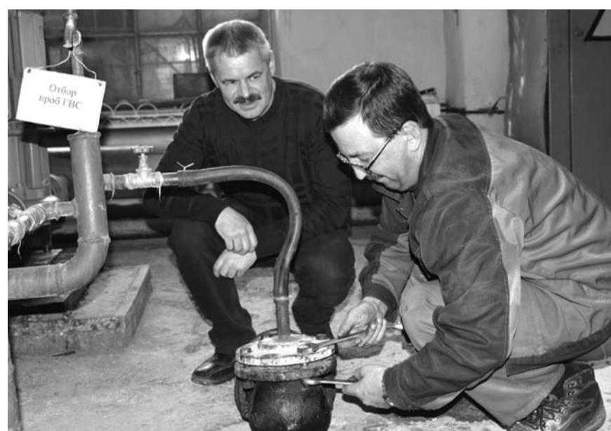
Все работы в котельной выполняются под контролем мастера Василия Сажинова (слева).
