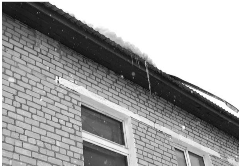
На доме, отремонтированном «варягами», рушится кровля.
