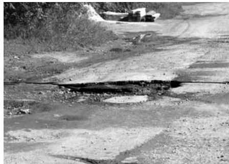
Участок дороги на улице Крылова, требующий ремонта.
