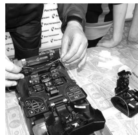
На этом аппарате свариваются оптические волокна кабеля.
