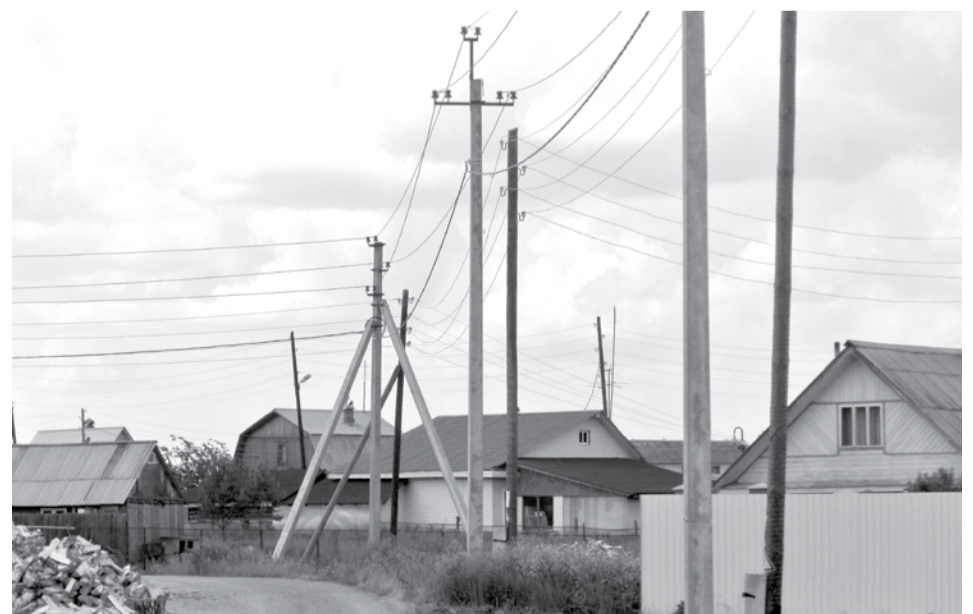
Новая линия электропередачи в Чудова.
