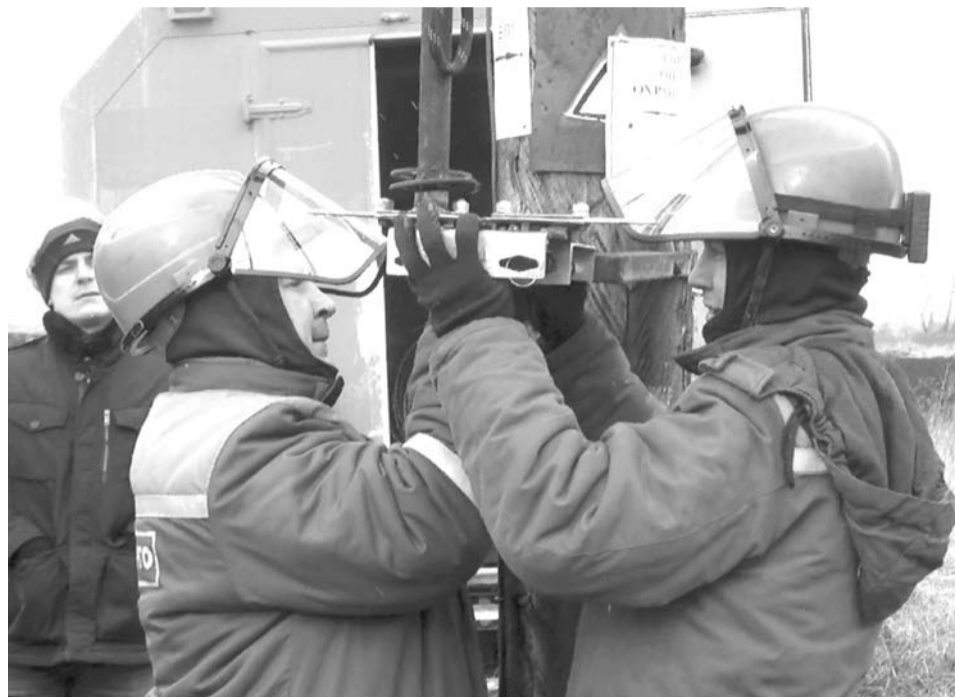
Работники ВЭС Александр Федянин и Дмитрий Половинкин производят замену привода выносного разъединителя 10 киловольт.
