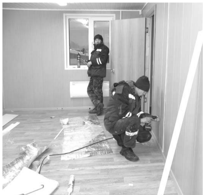
Последние штрихи в отделку помещений нового административного здания вносят работники ООО «АГАТ».
