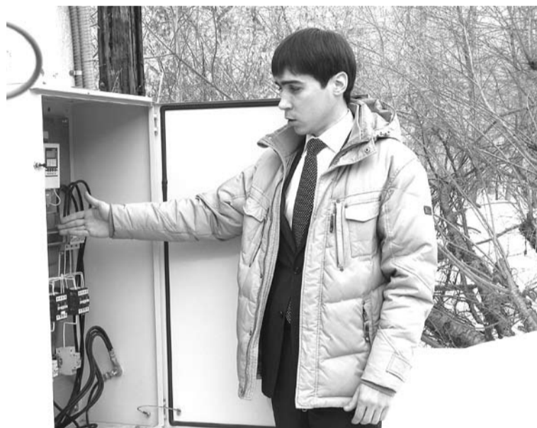
Начальник отдела ЖКХ и энергетики Сергей Куминов демонстрирует шкаф управления и учёта системы наружного освещения.
