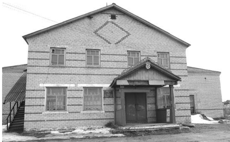
ДК с. Ильинского ожидает начала ремонта.
