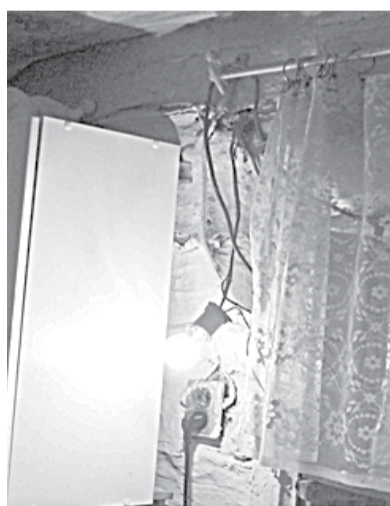
Во избежание пожара не допускайте эксплуатации старой проводки.
