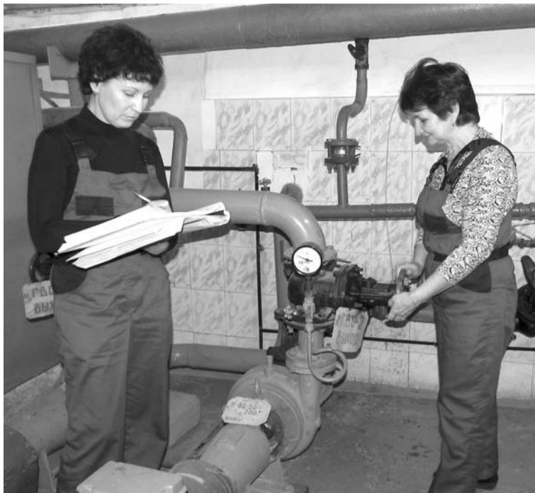
Операторы котельной № 2 МУП «БТС» Наталья Пургина и Валентина Климина ведут регулировку давления ГВС.
