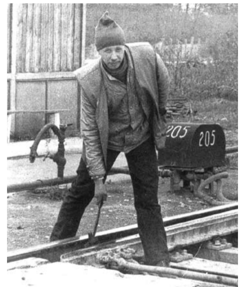
Алексей Шангин, электромонтер СЦБ, проверяет работу стрелки (1989 г.).
