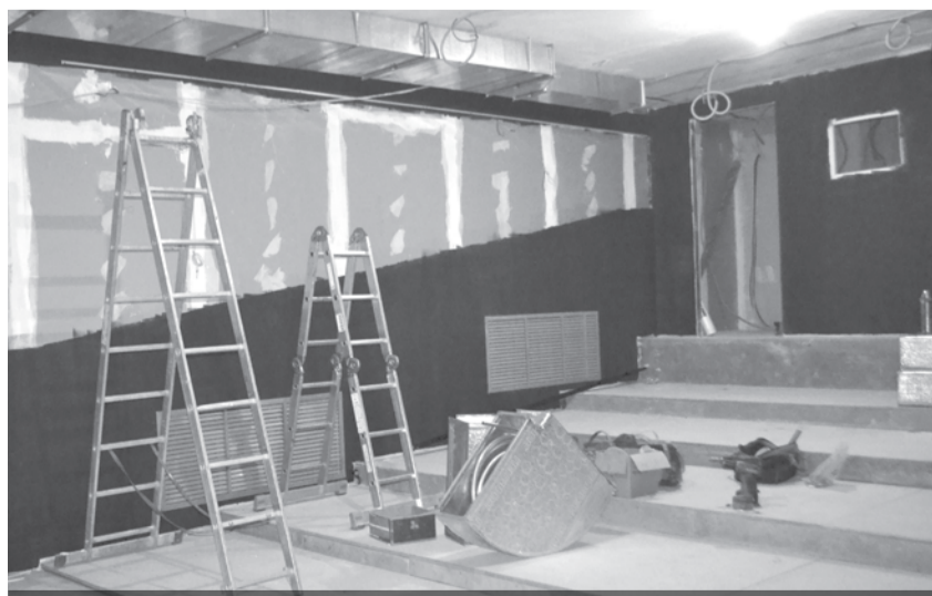
Строительные работы в кинозале близятся к завершению. Скоро начнут устанавливать кинооборудование. Такая огромная работа по строительству кинозала была проведена в кратчайшие сроки.
