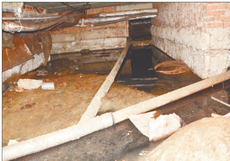
Подвал дома № 7а по ул. Промышленной представляет собой «болото», в котором что только не плавает
