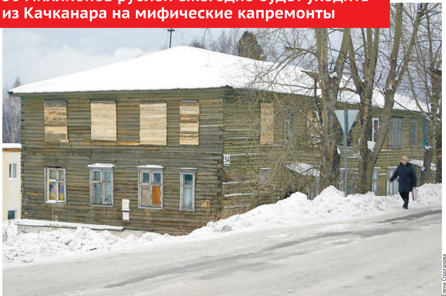
Этой деревяшке уже точно не дожить до капремонта
